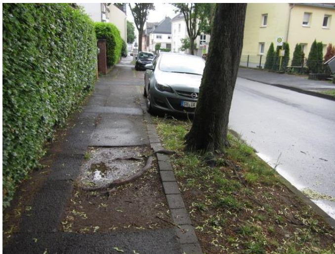
Bild 5: Beispiel für Wurzeln im Gehweg
