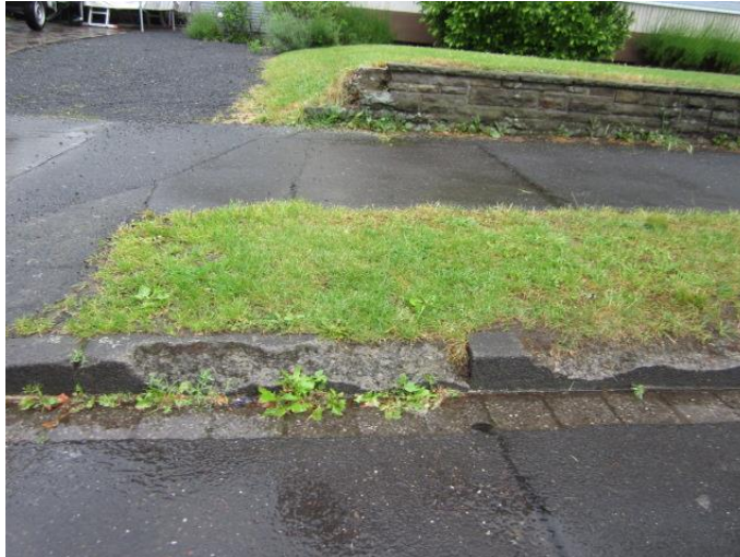
Bild 3: Beispiel schadhafter Borde
